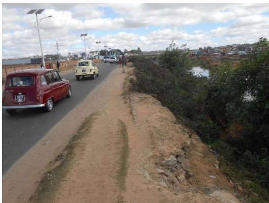
Ikopa rive droite - gabions partiellement démantelés et forte végétation en talus
