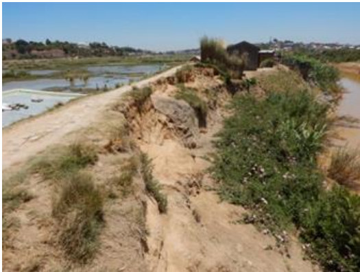
Sisaony (zone de glissement amont)
