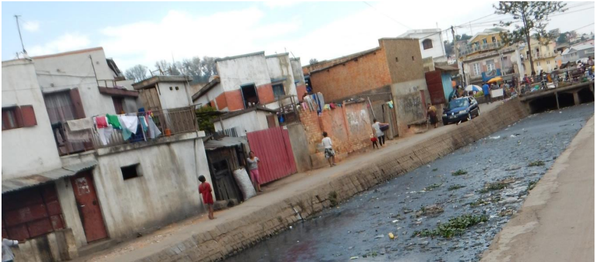
Fig. 56. Etat du canal C3 à côté du marché d'Anosibe (Novembre 2017)
